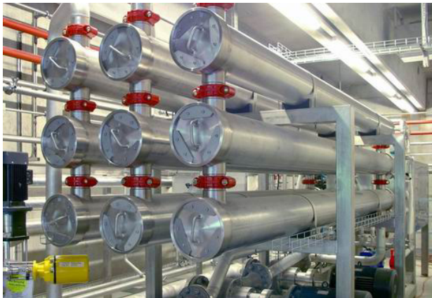
Abbildung 4: Umkehrosmoseanlage auf einem Praxisbetrieb mit Covergärung
